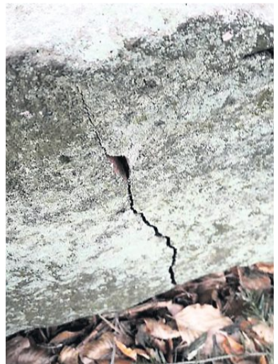
Ein tiefer Riss zieht sich durch diesen alten Grenzstein. Wolfram Schmied von der Bürgerinitiative Gegenwind macht dafür die ursachengemäße Verlegung des Steins aus dem Rodungsgebiet im „Stillfüssel“ verantwortlich.
